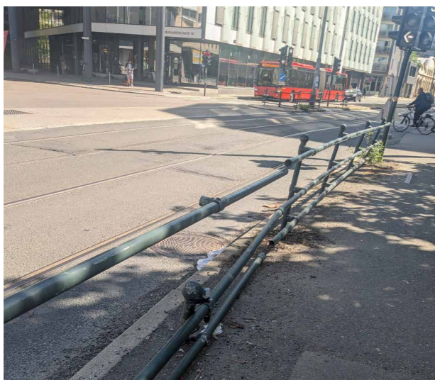
Ødelagte gjerder og stengsler i krysset Tøyenbekken / Schweigaardsgate / Annette Thommessens plass. Foto: SLA
