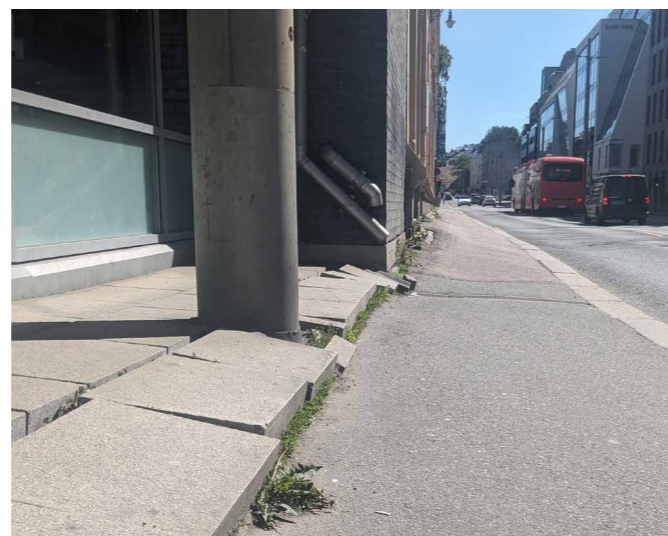
Smale fortau og overganger av dårlig kvalitet som mangler vedlikehold i Schweigaardsgate. Foto: SLA
